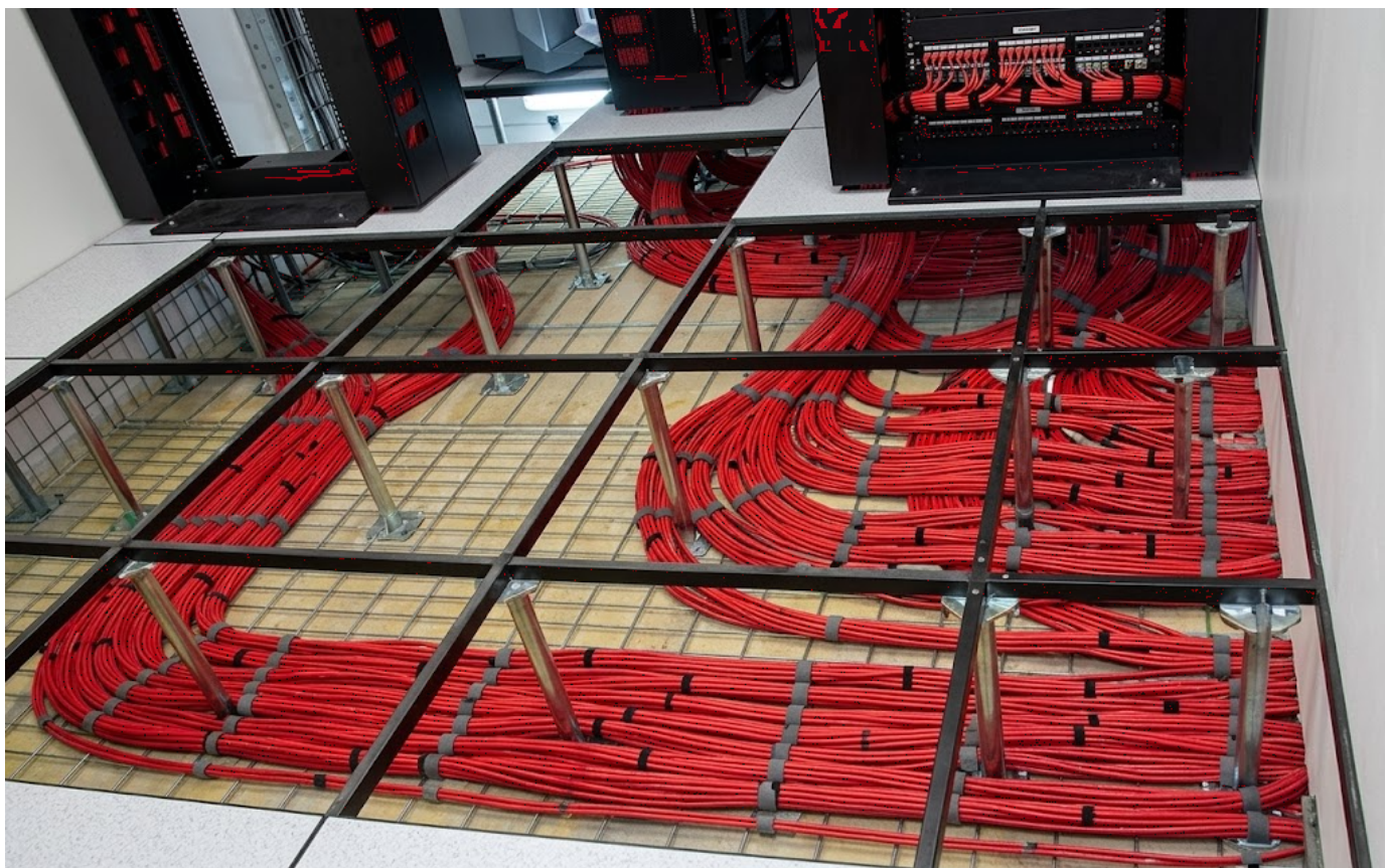
Cabos organizados sob piso elevado.
