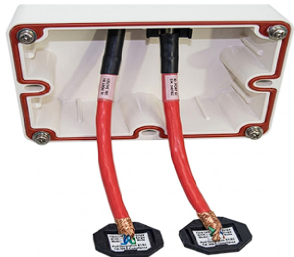
Cabos de link permanente identificados na área de trabalho.
