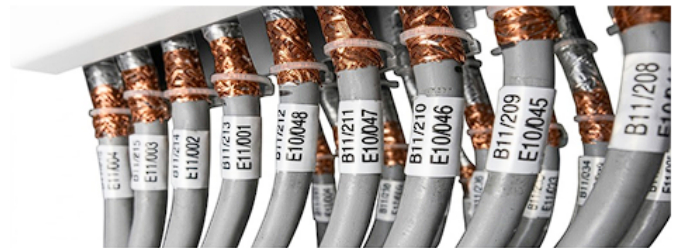
Cabos de link permanente identificados no patch panel.
